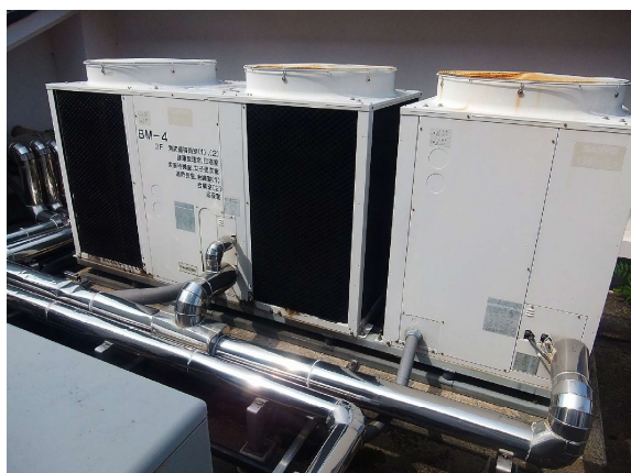
③ 3 階屋外 BM-4系統室外機
